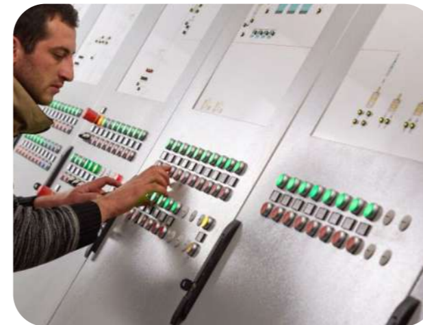
ПАНО АВТОМАТИЗАЦИИ AUTOMATION PANEL
